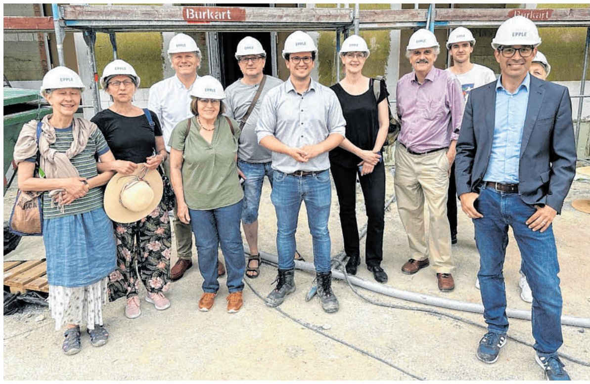
Die Grünen auf der Baustelle der „Schwetzingen Höfe“, die die Firma Epple auf dem früheren Pfaudler-Areal verwirklicht. BILD: GRÜNE
